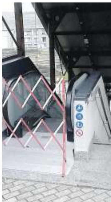
L'IMPIANTO La scala mobile guasta
